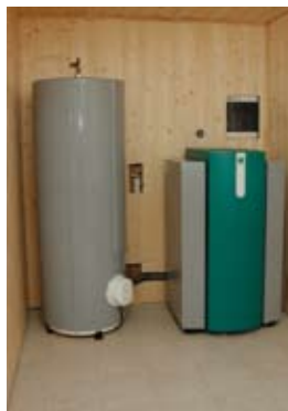
L'aspect d'une pompe à chaleur géothermique et de son ballon d'eau chaude est assez proche de celui d'une installation de chauffage classique avec chaudière
